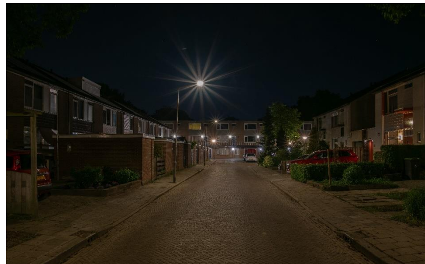
Nieuwe ledverlichting: goede gelijkmatigheid op de weg en weinig licht op de gevels
