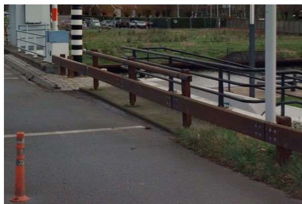
Figuur 4.4 Geleiderails fietstunnel Ringbaan-Westerschans (Ringbrug)
